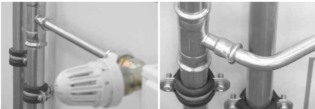
Radiatora savienojums (pieslēguma caurule un recirkulācijas caurule), izmantojot KAN-therm Steel sistēmu
