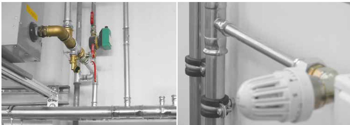
KAN-therm Steel sistēmas instalāciju piemēri
